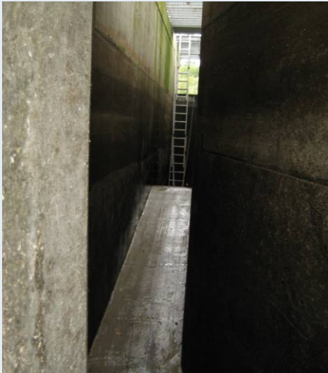
Überfallwehr im Bypass während der Bau- phase (im Hintergrund bauzeitl. Revisions- verschluss zum Unterwasser), Foto: A. Gluch
