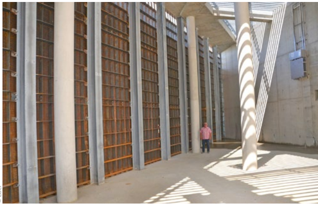
Bild 6: Bei dem Leitrechen der WKA Öblitz handelt es sich nach vorliegenden Kenntnissen um den größten 10-mm-Rechen Europas, das Foto zeigt den Rechen von der Abströmseite vor der Inbetriebnahme
